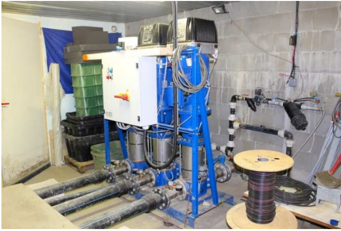
Les 3 pompes dans la station de pompage : une par parcours
