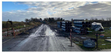
La voirie est en chantier le long de la départementale entre Mérignies et Tempelove, derrière une butte.
